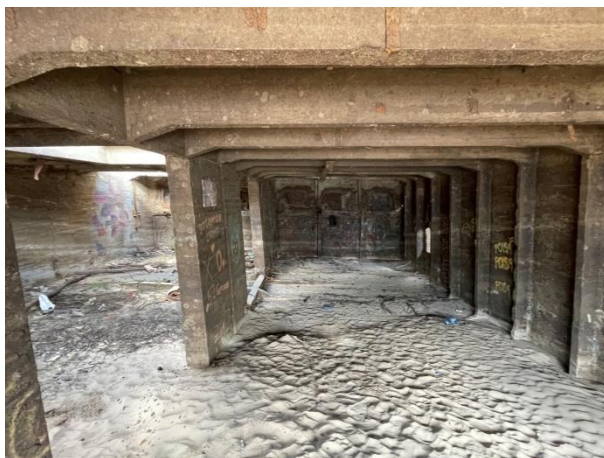
Техническое помещение. Машинное отделение
